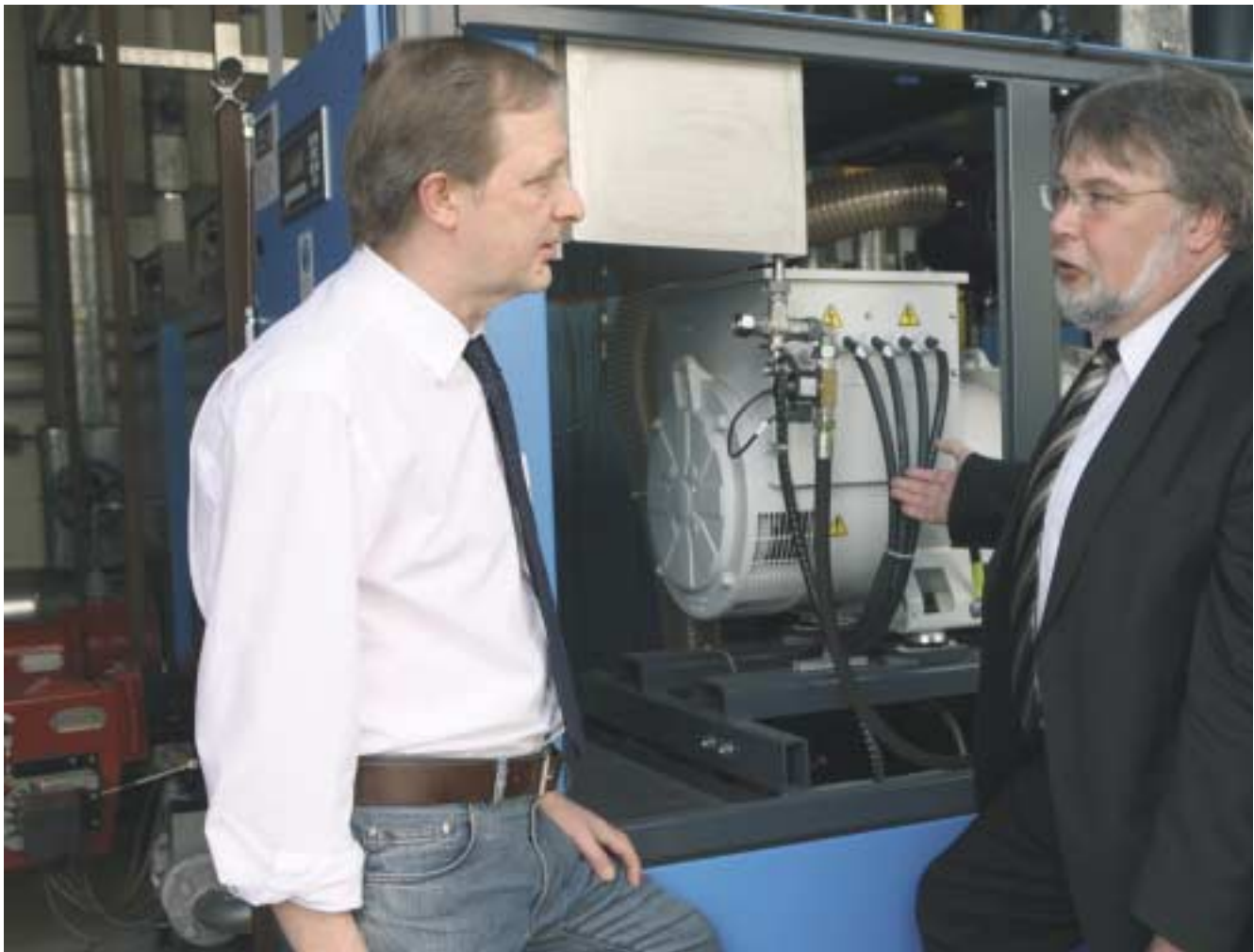
Mit gutem Beispiel voran – Stadtwerke Geschäftsführer Norbert Schüren und Rainer Kühne vor dem Blockheizkraftwerk in der Stadtwerke Liegenschaft „Am Krekel“
