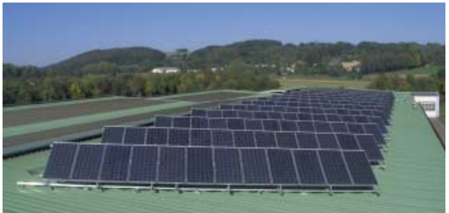
Die Photovoltaikanlage auf der Rottehalle der MEG in Cyriaxweimar
