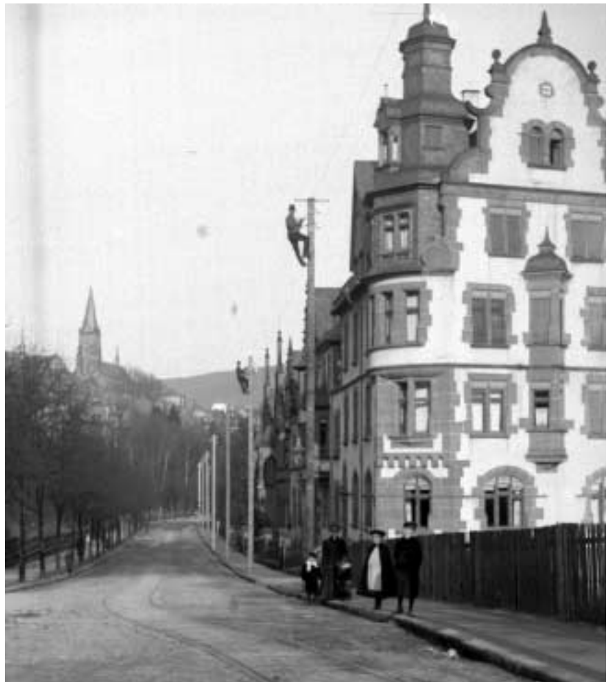
Aufbau der Freileitung in der Universitätsstraße
