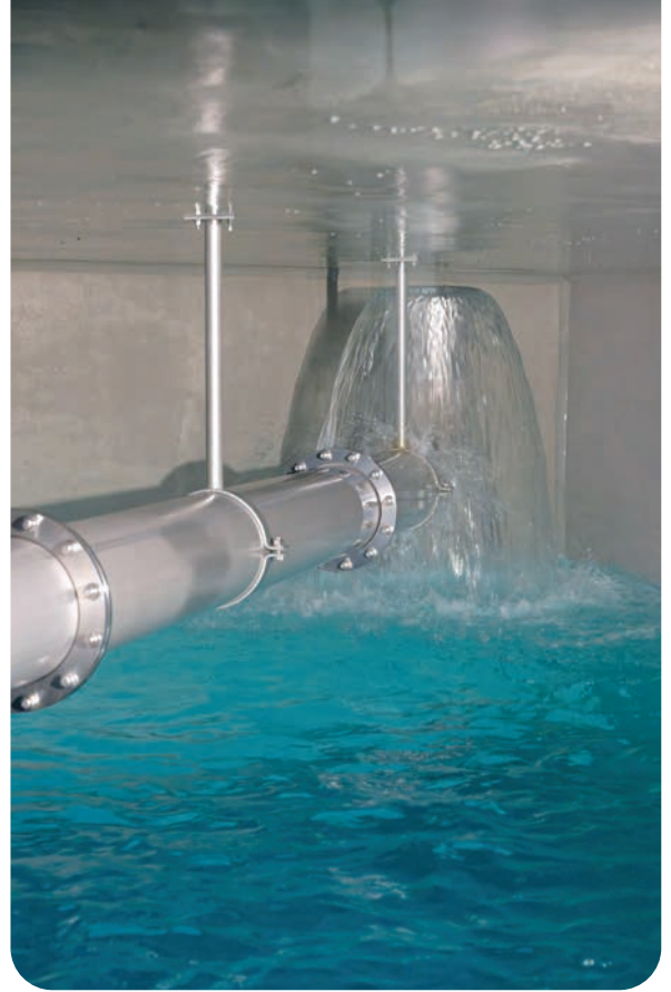
Blick in den Trinkwasserspeicher des neuen Wasserwerks.
